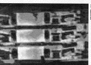
Figura 7.6 Isoterma en una imagen de infrarrojos de una caja de fusibles
